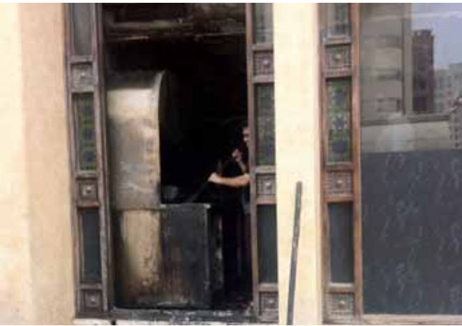
آثار الحريق داخل المطعم
